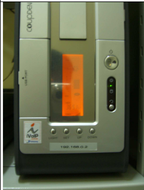
FOTO 3: detalhe do painel do servidor iVoIP.
