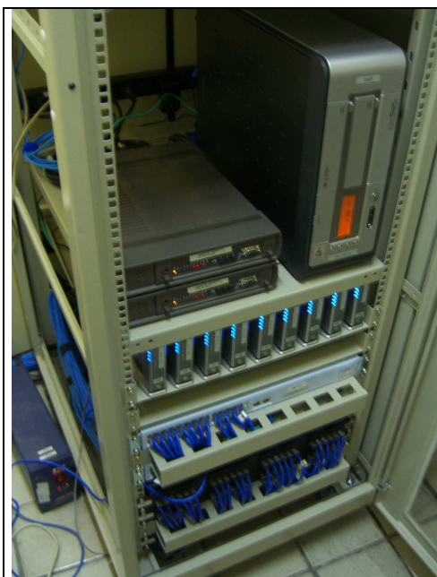
FOTO 1: detalhe do rack.
